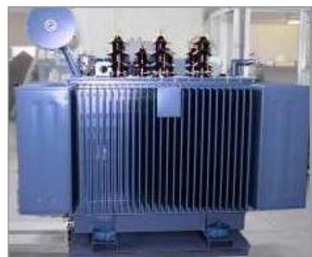
Trasformatore MT in olio
